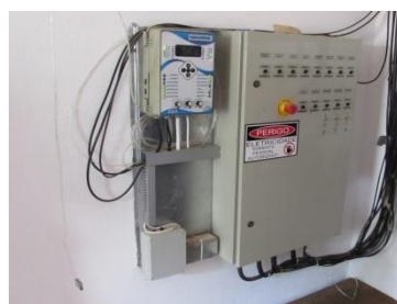
Figura 9. Foto do painel de controle de um aviário Dark-House, com parede de alvenaria.
